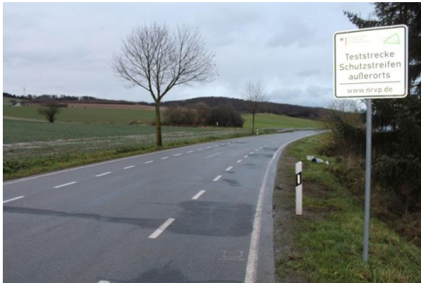
Abb. 35: Schutzstreifen bei Heckenbeck
